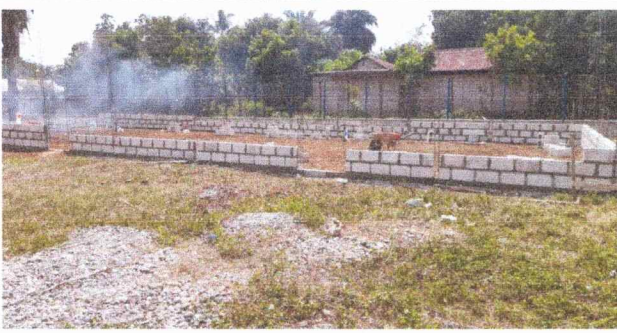
Foto 5: Se necesita tirar el piso en las 3 aulas
